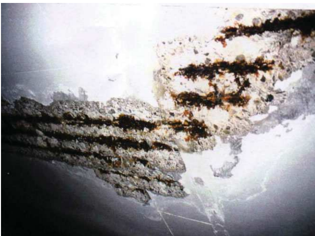
Bild 4 Deckenuntersicht mit großflächiger Betonabplatzung im und neben dem Reißbereich
