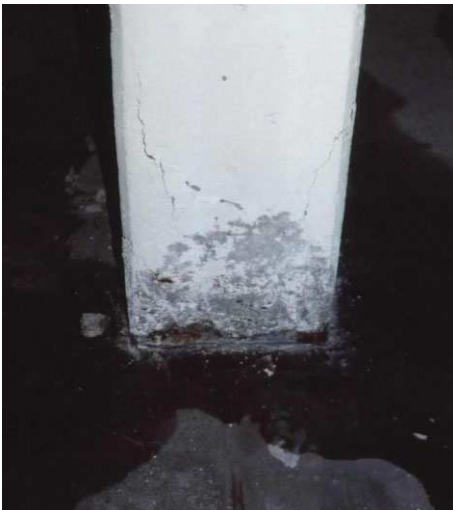
Bild 3 Risse und sich abzeichnende Betonabplatzung an einem Stützenfuß
