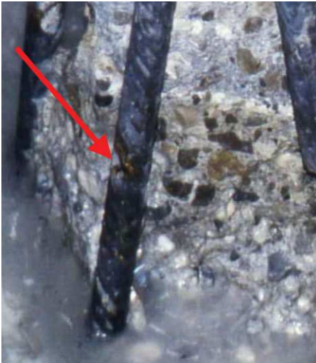
Bild 2 Chloridinduzierte Lochfraß-Korrosion an einem Bewehrungsstab
