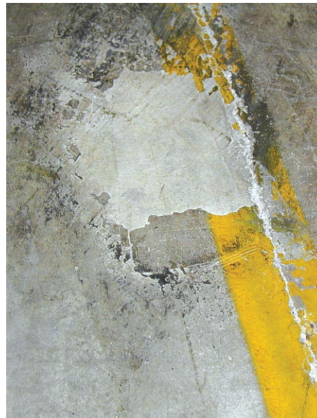
Bild 6. Abgelöste Hartstoffeinstreuung neben einer Fuge Fig. 6. Delamination of hard material nearby joint
